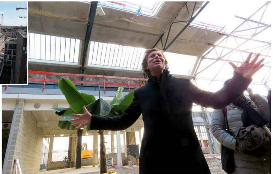
Saint-Ouen, début février. Olivier Saguez, fondateur de l'agence de design Saguez & Partners, fait visiter le chantier de la Manufacture Design, qui intégrera ses locaux mais aussi une école spécialisée. (LP/NR/C.G.)
